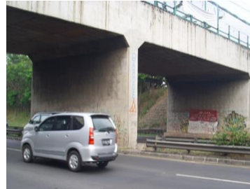
(d) Kolom jembatan di tengah median tanpa pelindungan yang baik
