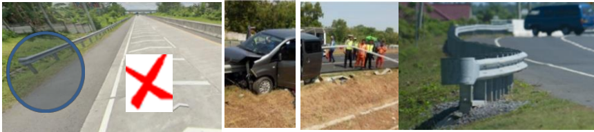
b. Hazard Ujung Pagar Keselamatan
