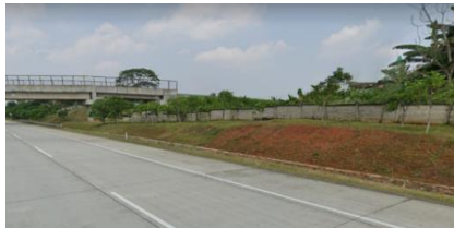
(c) Hazard objek menerus berupa saluran drainase pasangan batu ataupun beton tepat di tepi bahu jalan.
