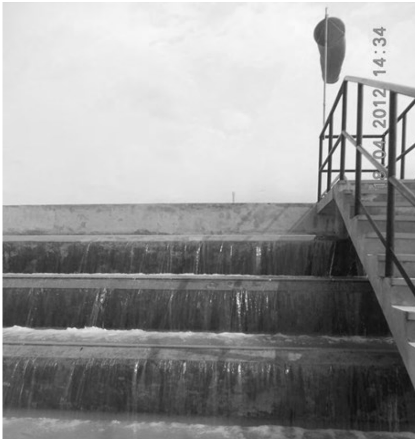
Gambar 5. Unit Aerator Instalasi PT AAT di Sepatan
